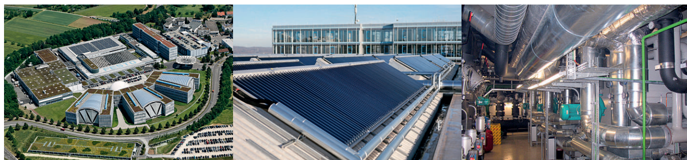
Abb. 3.3-1: Von links: Luftaufnahme des Firmengeländes der Festo AG & Co. KG in Esslingen, Kollektorfeld, Adsorptionskälteanlage, Quelle: Festo
