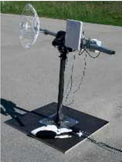
Automatische 2-Achs-Antennennachführung mit einer 5,8-GHz-Patchantenne und einer 2,4-GHz-Parabolantenne
