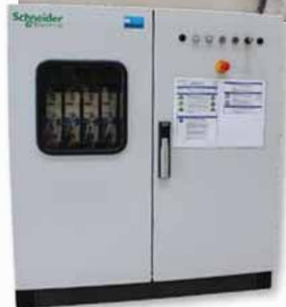
Der zugehörige Schaltschrank
